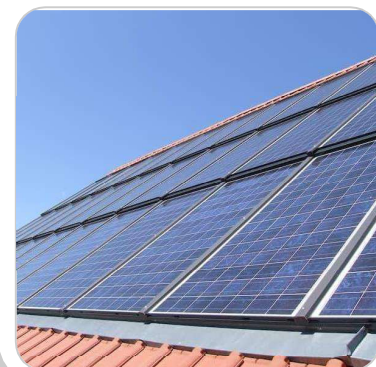
- Beispiel Photovoltaik (Schrägdach)
