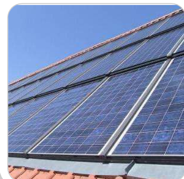
- Beispiel Photovoltaik (Schrägdach)
